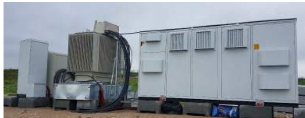
Exemple d'onduleurs et transformateur installés à l'extérieur
